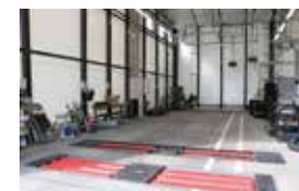
検査ラインには各種大型車用検査機器を設備。多様な車種の検査に対応。
