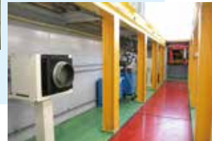
ピット内もエアコン完備。転落防止のピットカバーも設備。
