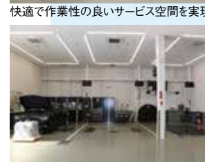
一般整備ストールにはタンデムリフトを設備。ワイド仕様で重整備にも対応。
