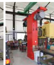
各種リールは自立型マルチリール取付架台に設置。リフト制御盤も内蔵。
