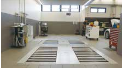
検査ライン。ヘッドライトテスター、ケーブルも埋設
