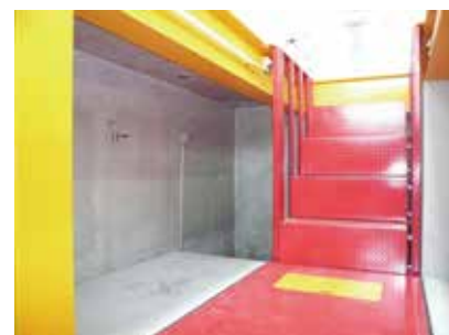
※フロアーリフト内部
