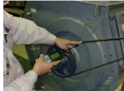
ファンベルト緩み確認
