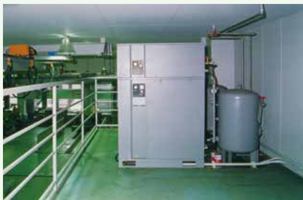
＜設置例＞ 中2階に設備したパッケージコンプレッサーと補助タンク (注:現モデルとは違います)
